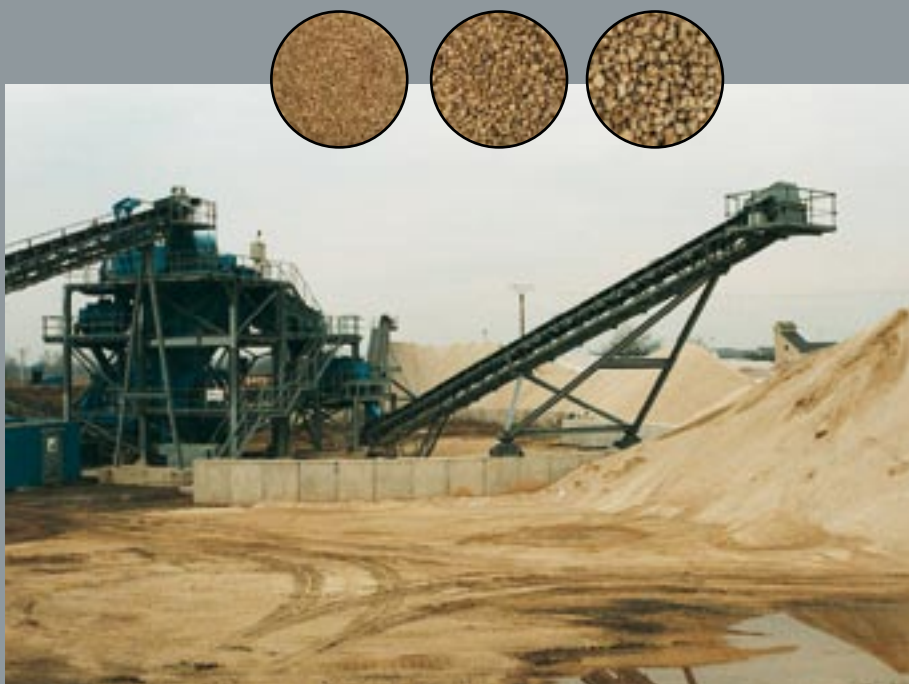
In der Bims-Waschanlage wird das Waschwasser im Kreislauf gefiltert und mit geringen Mengen Frischwasser ergänzt. Sämtliche aufbereiteten Rohstoffe gelangen in die weitere Produktion.
