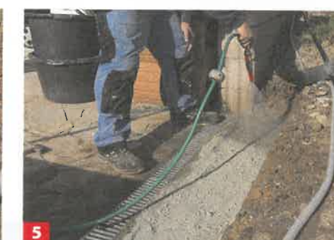
5 Halten Sie einen Schlauch bereit, um gleichmäßig Wasser hinzugeben zu können (stets Hinweise des Mörtelherstellers beachten).
