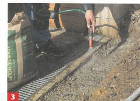
3 Je nach Mörtelart mischen Sie den Beton vorher mit Wasser an oder füllen ihn lagenweise ein und geben direkt Wasser darauf.
