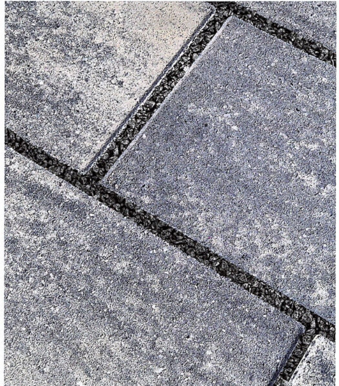
Trendline-Pflaster Aqua in der Farbe anthrazit-weiß-nuanciert: Der vergrößerte Fugenabstand erhöht die Versickerungsleistung. Foto: JASTO Baustoffwerke, Ochtendung
